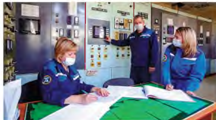
На ЦПУ котельной обсуждают выдачу тепла в корпуса. Все решения фиксируют в журналах рапортов
